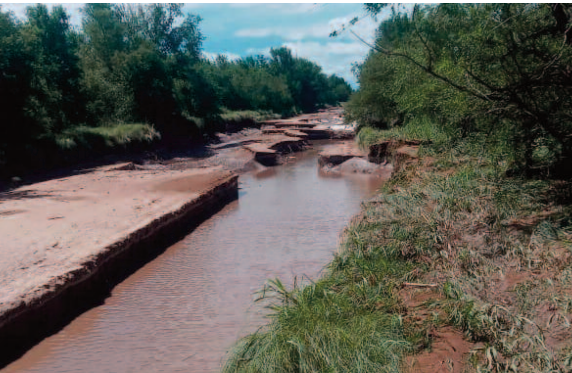
Profundas cárcavas provocadas en caminos rurales por las intensas lluvias.
